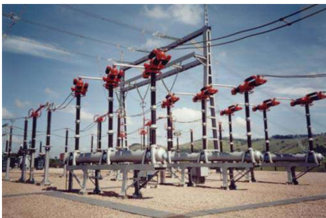
Figura 5.1: Disjuntor PK6 Delle Alstom a Ar-Comprimido-460kV (CTEEP Cabreúva).
